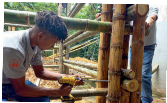
Ein Junge vom Bambushandwerk bei der praktischen Arbeit, Erstellung eines Grundstocks eines Wohnhauses.
